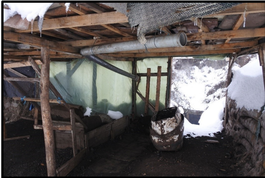
Fig. 35. Impianto artigianale di ventilazione nella jama di LŠ. con tubi di plastica.
