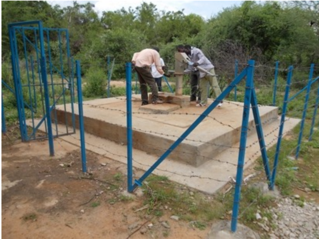
Photo 9 : Un ella adadi réhabilité par une ONG et géré par le système du comité de l'eau près de Hudet.
