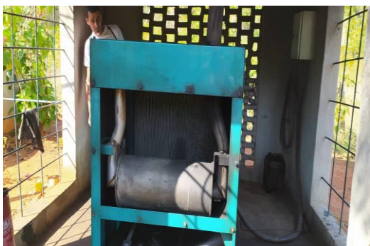
Fig. 10: Características del grupo electrógeno de la comunidad Hoyo de Padilla. Fuente: Base de datos Proyecto FRE local.
